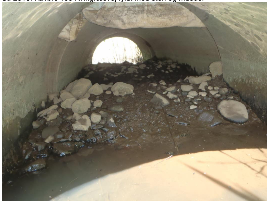
St. 2916: Rørbro ved Kvikgræsvej fyldt med sten og mudder
