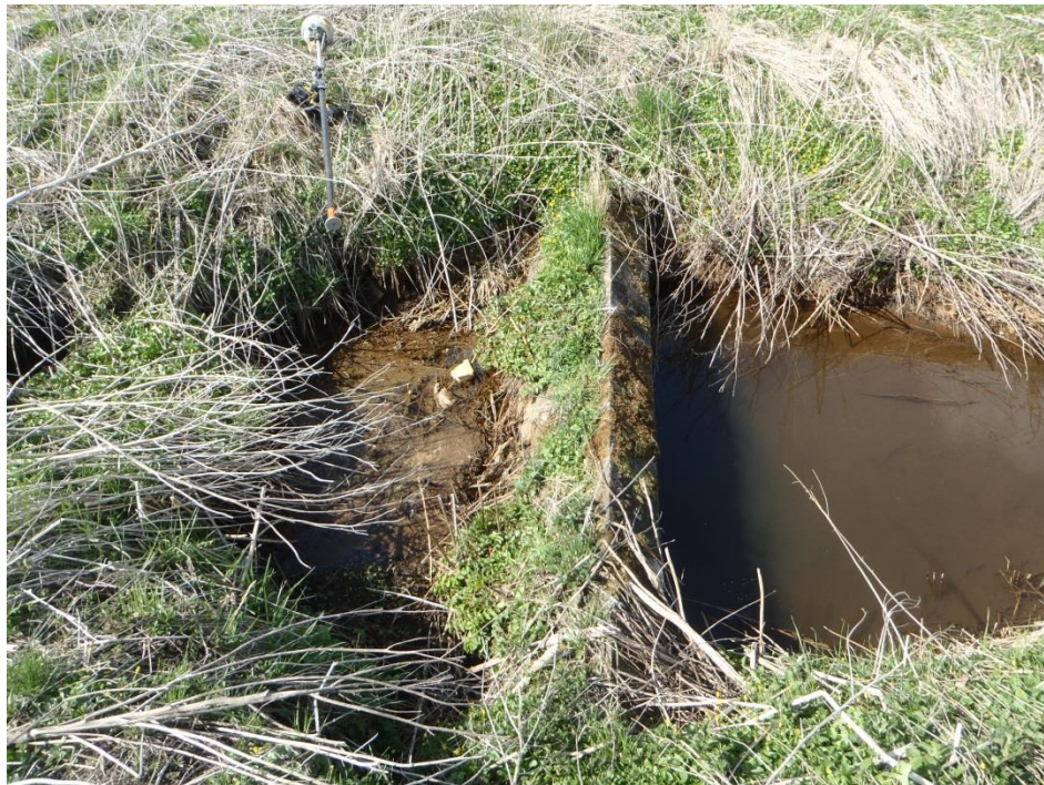
St. 1312: Væltet betonmur i vandløbet
