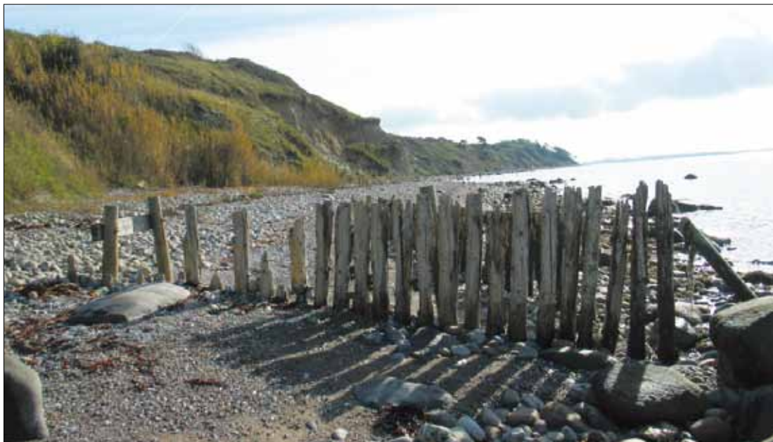
Eksempel på udtjent kystbeskyttelse. Foto: Kalundborg Kommune.
