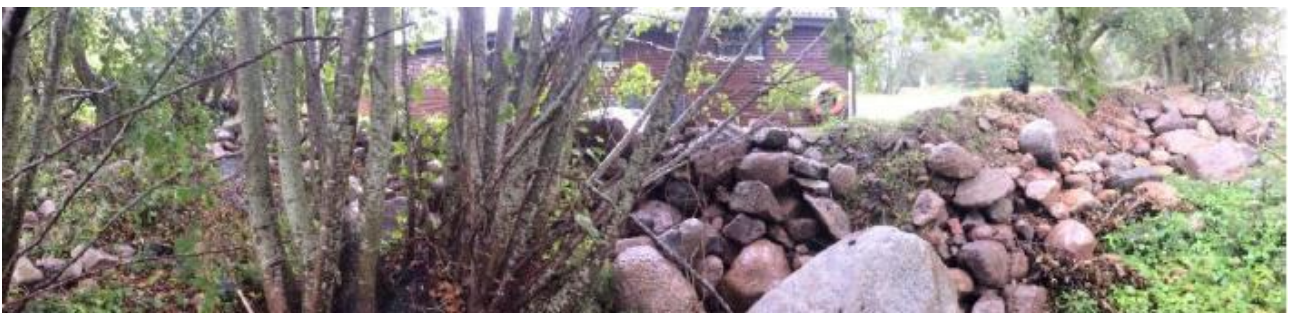
2 - Billede af diget fra besigtigelse d. 26. september 2024.
