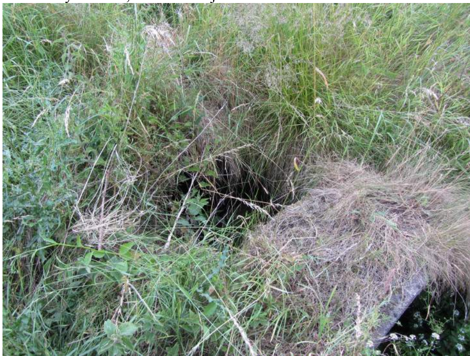
St. 1813. røroverkørsel. Rørelementer adskilt.
